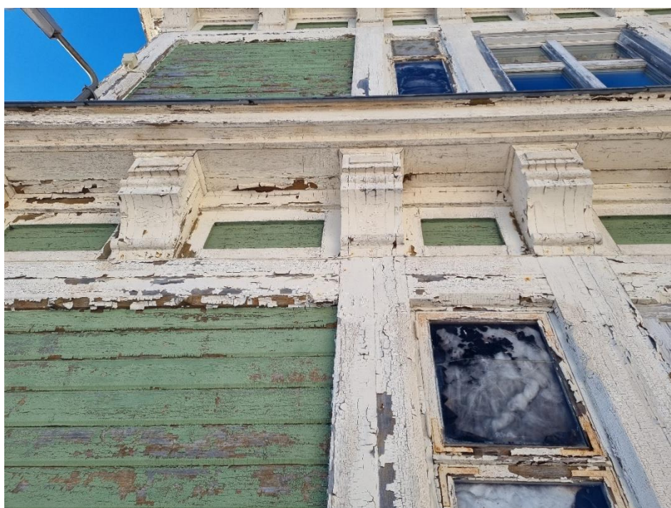
Ovan bild. Detalj av fasad med starkt nedbrutna färgskikt.
