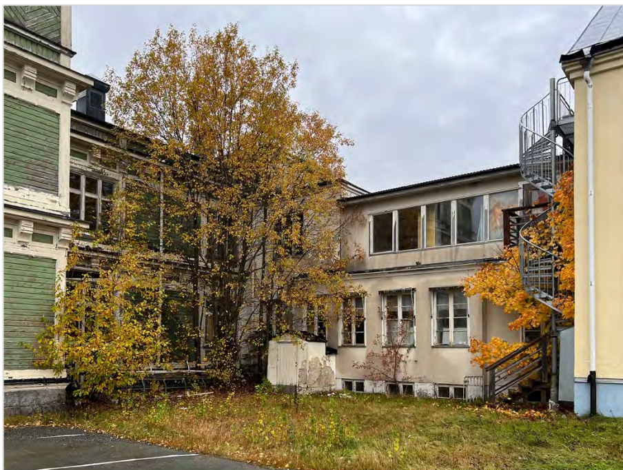
Länken till volontärskolan byggdes på med en våning 1988. Växtligheten i detta läge har bidragit till omfattande skador framförallt på volontärskolans träfasad.
