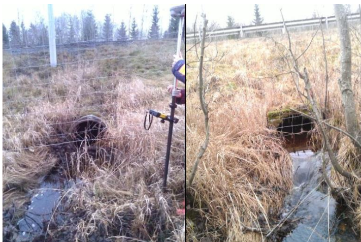
Figur 3.11 Trumma under väg E4 (Ramböll, 2012).
